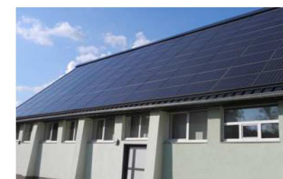
Sur le toit de la salle des fêtes : 170 m 2 de panneaux photovoltaïques.
